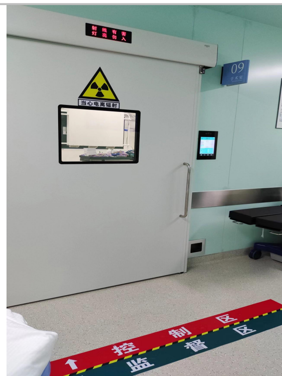
医疗综合楼四楼复合手术室 机房防护门、警告标志、工作指示灯等
