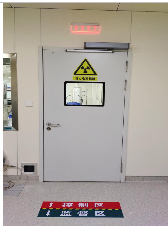
医疗综合楼四楼复合手术室控制室防护门、 警告标志、工作指示灯、闭门装置等
